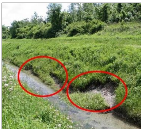
Solche Uferabbrüche sollen durch die Sanierung vermieden werden.
